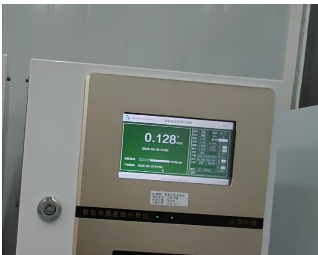
图 2.2-1 现有项目废水处理站出水 pH、COD、氨氮在线监测（已联网）
